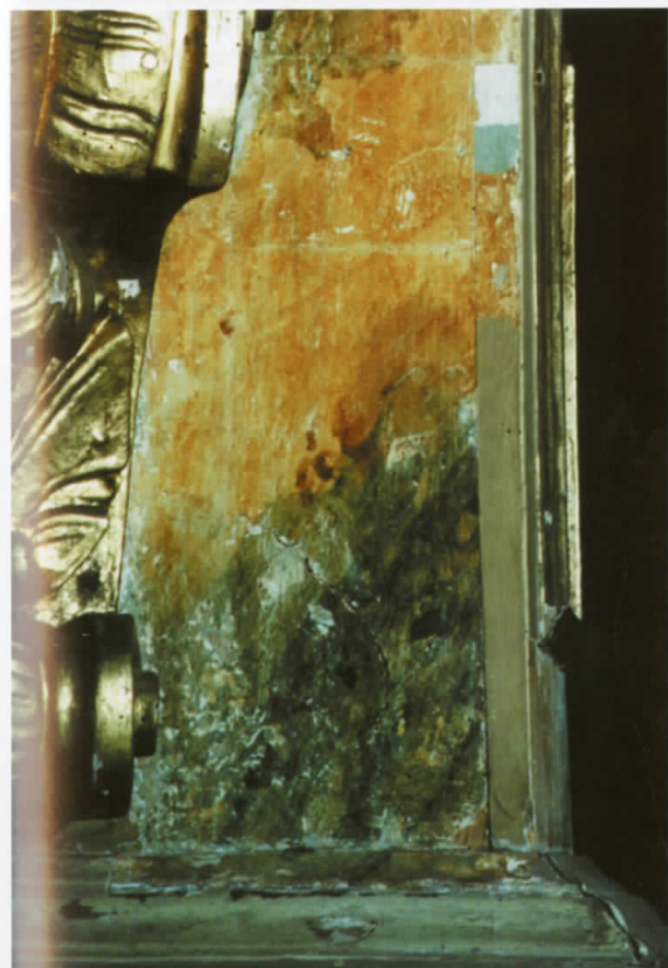
Fragment bocznej ścianki cokołu, w trakcie prac odkrywkowych. W obszarze odsłoniętej i dobrze zachowanej oryginalnej marmoryzacji widoczne są głębokie pęknięcia.
