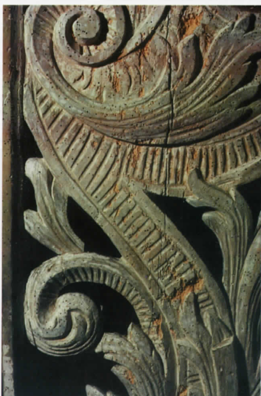
Dolny fragment prawego uszaka. Stan po usunięciu jedynych, wtórnych opracowań z lat 60. XX wieku. Widoczny brak jakichkolwiek oryginalnych opracowań. Drewno dotknięte destrukcją biologiczną z licznymi otworami po owadach.
